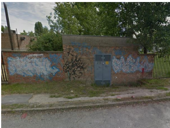
1882 sz. 10/0,4 kV-os épületben elhelyezett transzformátor a Panel utcában
